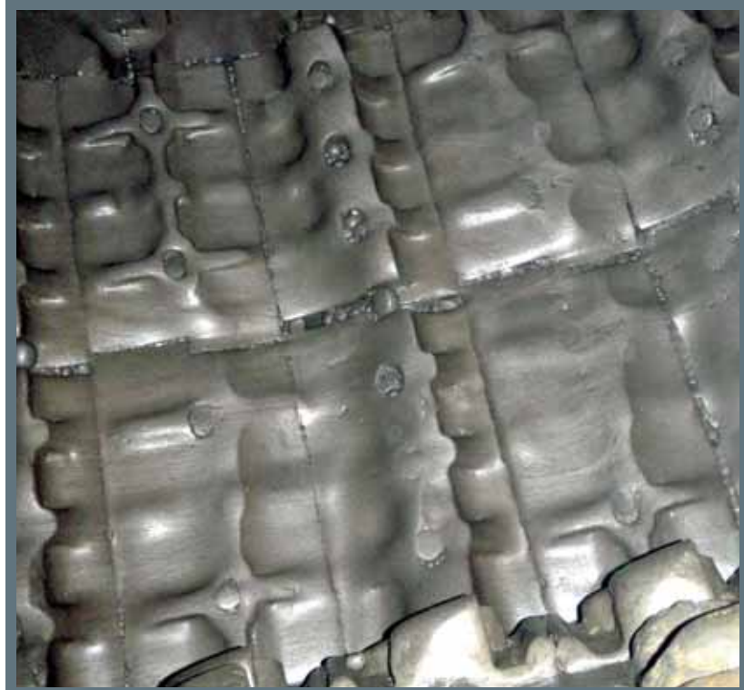
Рис. 4. Верх: Новая футеровка 110Г13Л мельницы ММС 90х30 Низ: Футеровка 110Г13Л мельницы ММС 70х23 на 2/3 срока эксплуатации
